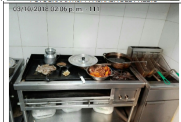
FOTOGRAFÍA No.3 ESTUFA DE 2 PUESTOS CON PLANCHA INTEGRADA Y UNA FREIDORA
